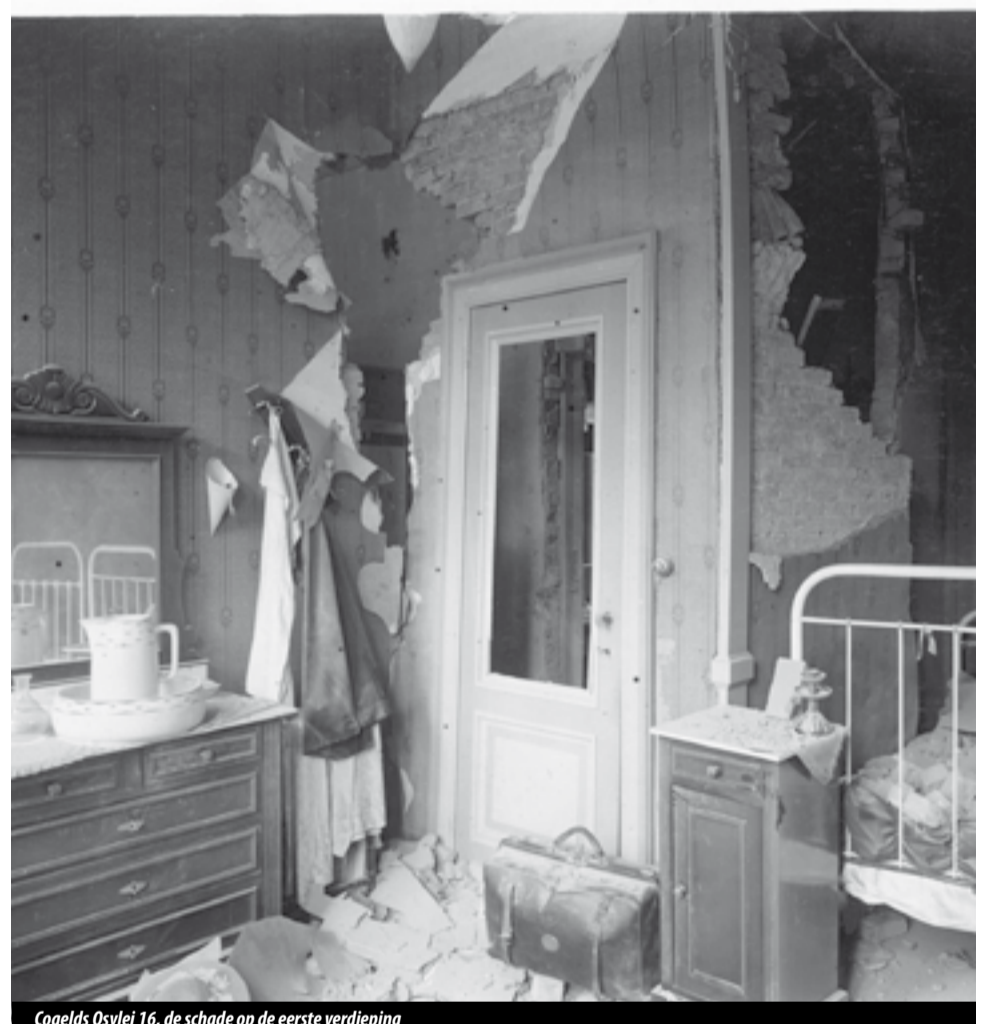
Cogels-Osylei 16, de schade op de eerste verdieping
